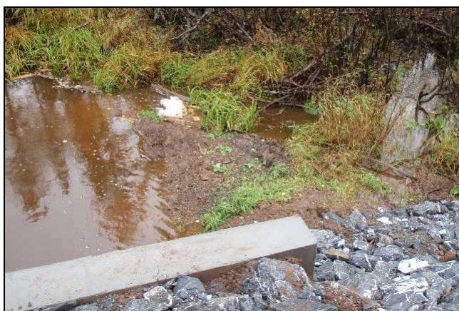
Sortie du ponceau non stabilisée
