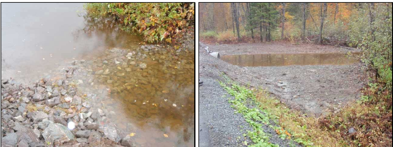
Station 67, km 19,6 : Entrée du ponceau stabilisée de façon inadéquate
