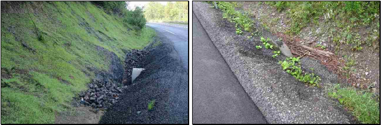
Figure 8: Absence de stabilisation par enrochement à l'entrée des ponceaux; Stations 14 et 93
