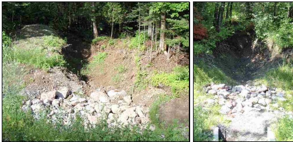
Figure 10: Fossés présentant une instabilité des sols; Stations 107 et 17
