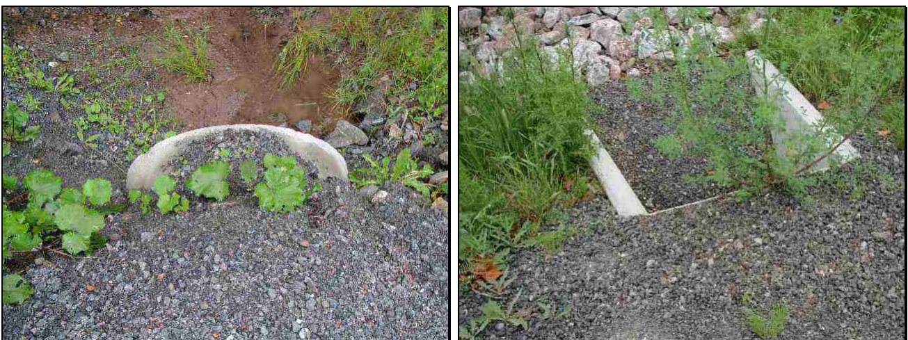
Figure 22: Gravier de recharge de l'accotement tombant dans le ponceau; Stations 34b et 53
