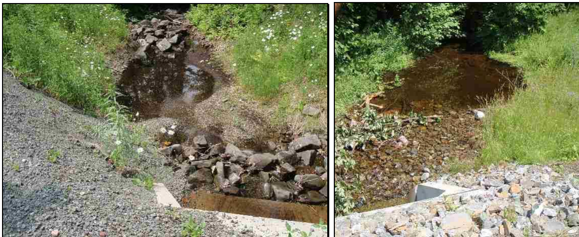
Figure 15: Creusage inadéquat du lit du cours d'eau et stabilisation inefficace des berges; Stations 43 et 119
