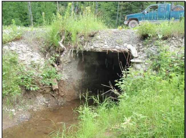
État du ponceau lors de l'évaluation initiale du 9 juillet 2010
