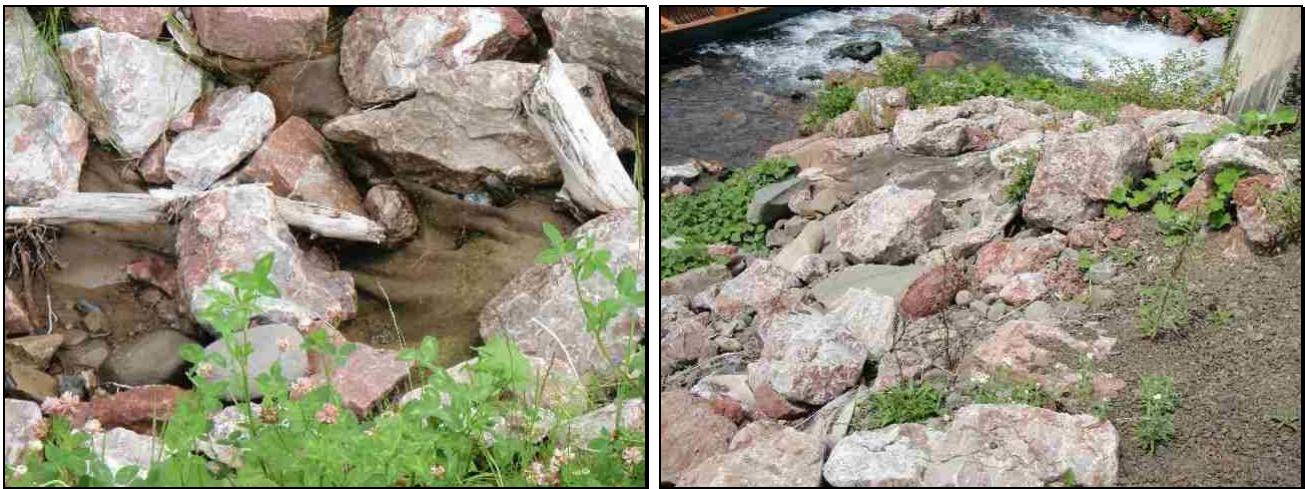
Figure 26: Géotextile exposé et instable; Stations 35 et 117
