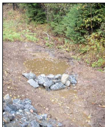
Entrée du ponceau non stabilisée
