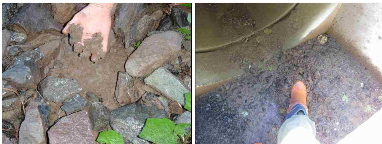
Figure 3: Dépôts importants de sédiments; Stations 12 et 31
