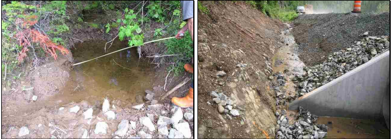
Figure 16: Cours d'eau et sources d'eau permanents creusés mécaniquement, présentant des lacunes en matière de stabilisation; Stations 30 et 101
