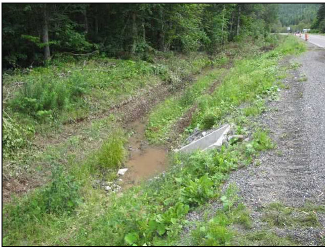
Traces de machinerie dans le cours d'eau
