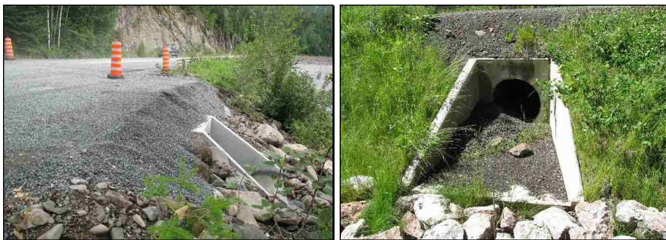
Figure 24: L'élargissement de l'accotement au-dessus du ponceau : un phénomène répandu dans tout le réseau; Stations 101 et 25
