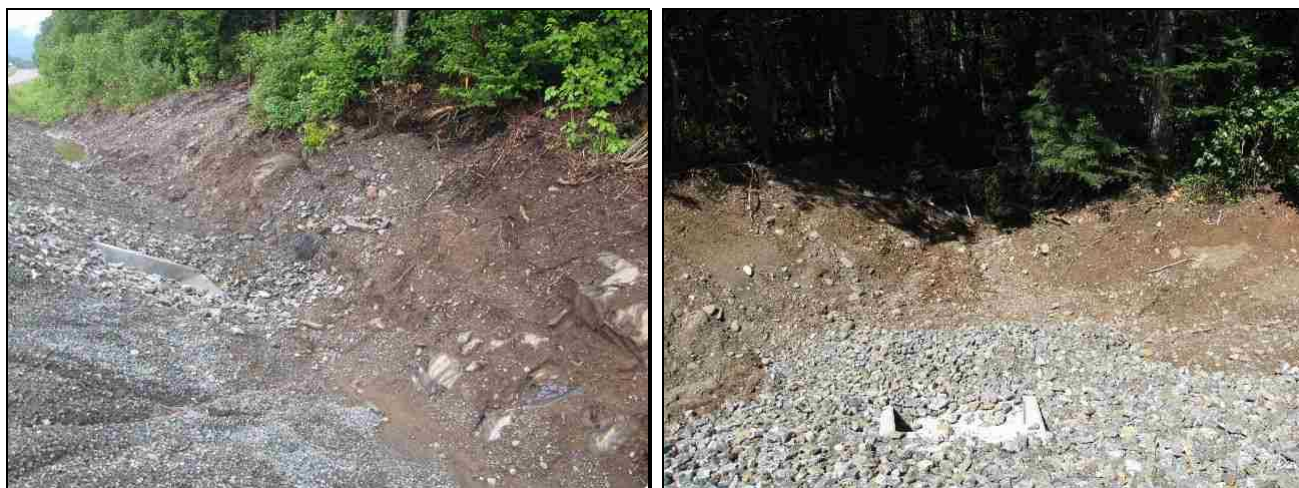
Figure 5: Enrochement insuffisant, dimension des pierres trop petite et pentes trop fortes; Stations 98 et 100
