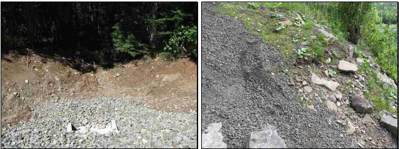
Figure 25: Pentes inadéquates des déblais et remblais des zones situées à moins de 20 m des cours d'eau; Stations 21 et 30
