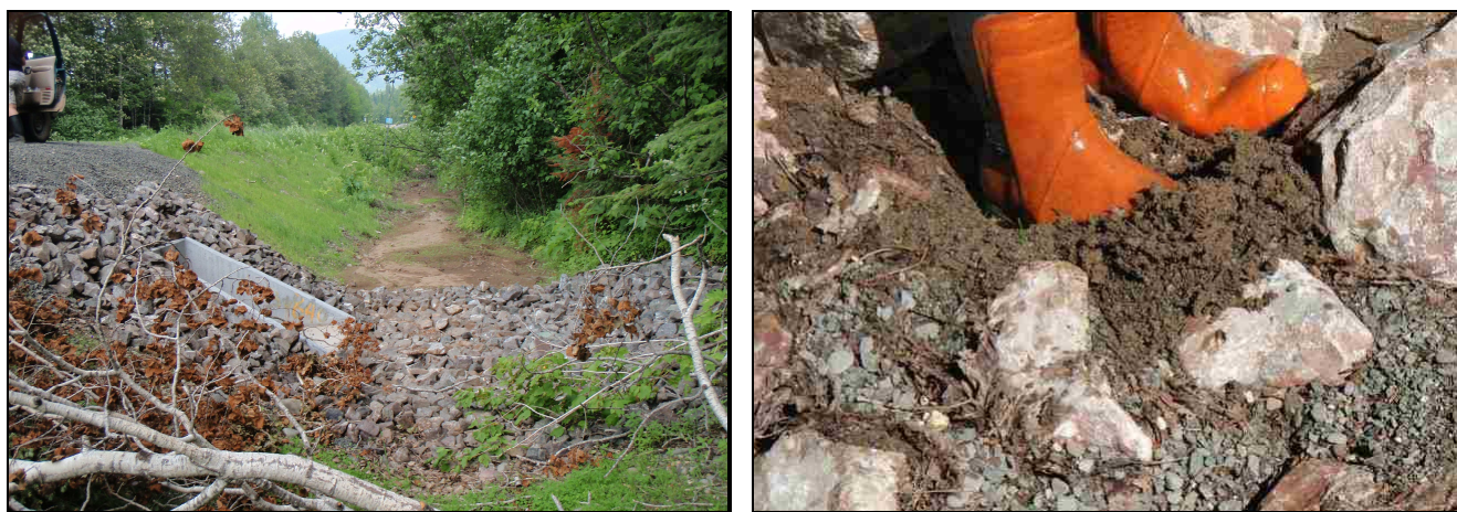
Figure 7: Colmatage de la vase dans l'enrochement; Stations 44 et 15
